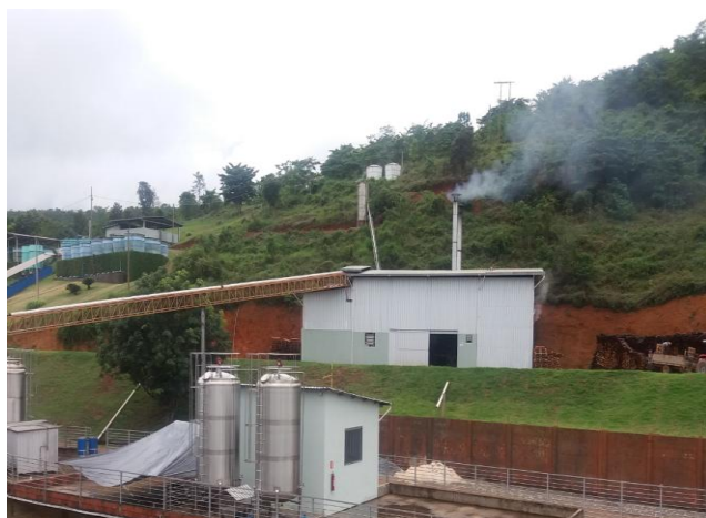
Foto 06: Caldeira à lenha.
