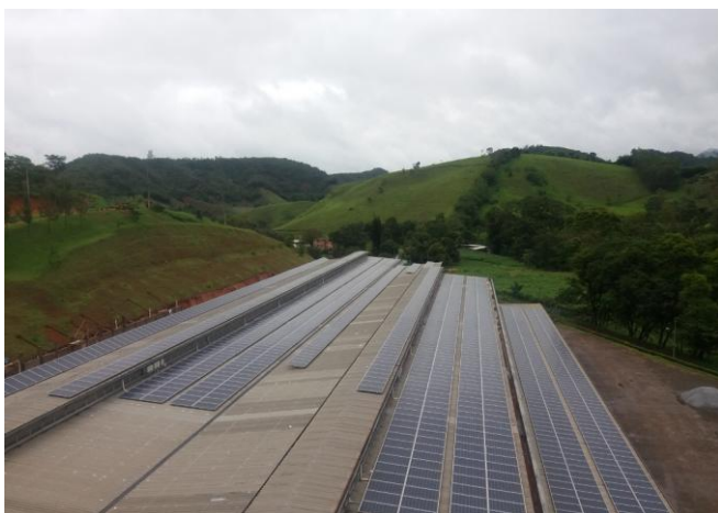
Foto 05: Sistema de energia solar fotovoltaica.
