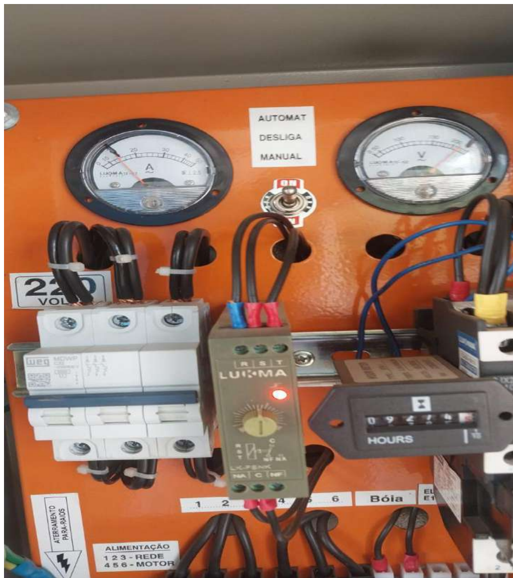
Caixa Elétrica do Poço Tubular Profundo
