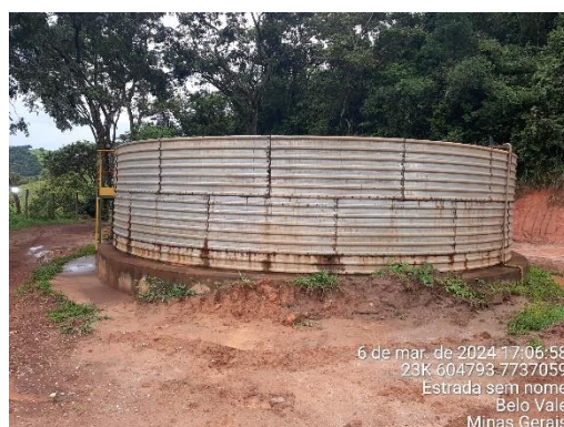
Foto 22: Tanque de espera para bombeamento de água.
