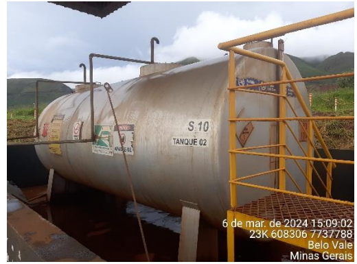
Foto 26: Tanque de 30.000L contido em estrutura de alvenaria impermeável.
