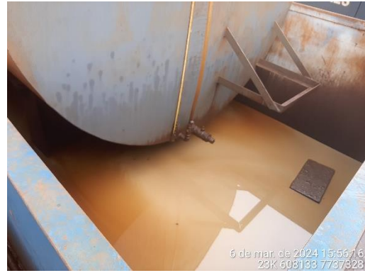
Foto 32: Borra de óleo e água de chuva dentro da caixa de contenção metálica.
