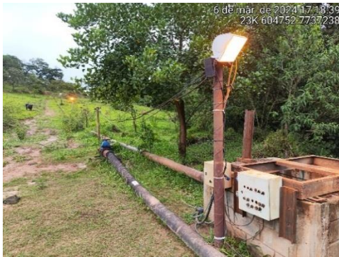
Foto 63: Parte da adutora próximo à captação de água no rio Paraopeba.
