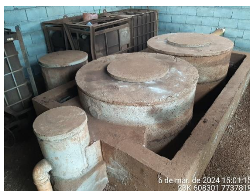
Foto 58: CSAO Final que recebe os efluentes das CSAO da oficina e lavador de veículos e do ponto de abastecimento.
