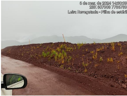
Foto 7: Talude na pilha de estéril revegetado necessitando de manutenção e readequação.
