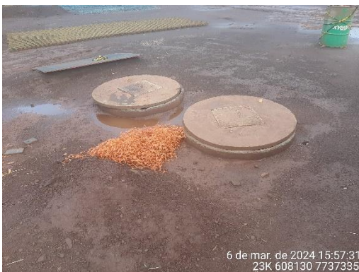
Foto 33: CSAO que recebe efluente da área de alvenaria em que ficam contidos os geradores e o tanque de combustível.
