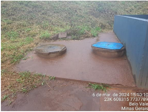
Foto 25: CSAO que recebe o efluente do ponto de abastecimento.
