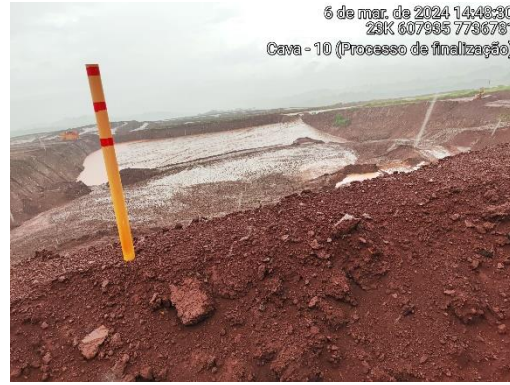
Foto 14: Baia (cava ou caixote) que está recebendo rejeito atualmente.
