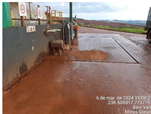
Foto 24: Pista e bombas cobertas circundadas por canaletas de drenagem de efluentes.
