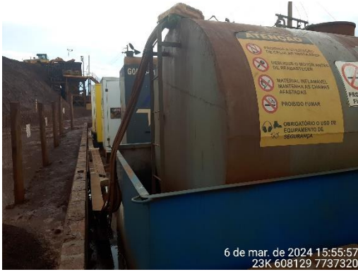
Foto 31: Caixa de contenção metálica do tanque de combustível.
