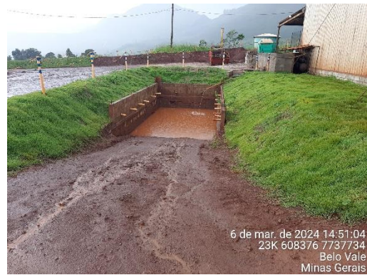
Foto 42: Baía de sedimentação do efluente proveniente da oficina e lavador de veículos.
