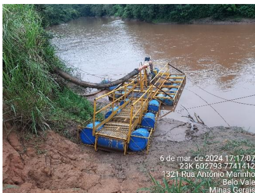
Foto 19: Ponto de captação de água no rio Paraopeba através de sistema de bomba flutuante.
