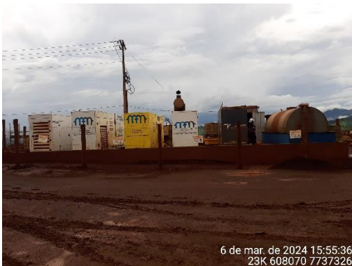
Foto 29: Geradores e tanque de combustível de 10.000L para fornecer energia para UTM e estruturas associadas.
