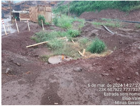
Foto 61: Fossa séptica que recebe efluentes dos banheiros próximos a UTM e almoxarifado.
