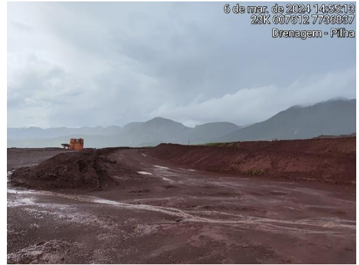
Foto 8: Talude sem cobertura vegetal que deverá ser objeto de recuperação.
