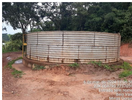
Foto 20: Tanque de espera para bombeamento de água.
