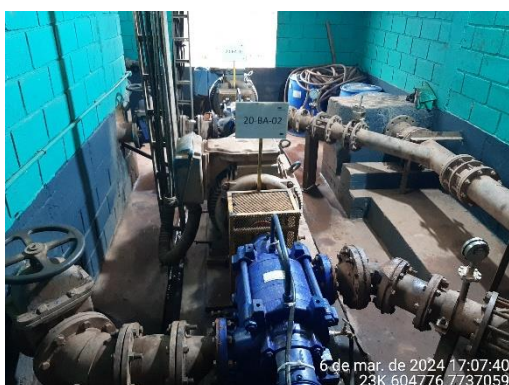
Foto 21: Casa de bombas que conduzem a água do tanque de espera para o tanque de água nova através da adutora.
