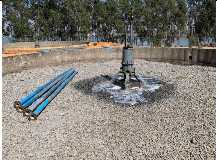
Foto 6. Filtros de brita
