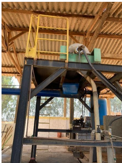
Foto 7. Centrifuga para remoção de água do lodo
