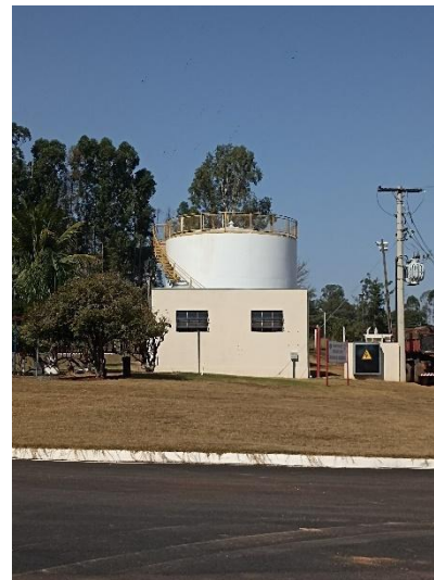
Foto 4. Reservatório de água em caso de incêndio
