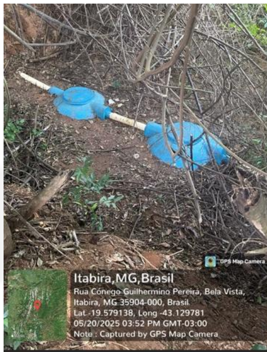
Foto 04. Sistema de tratamento de efluente sanitário.
