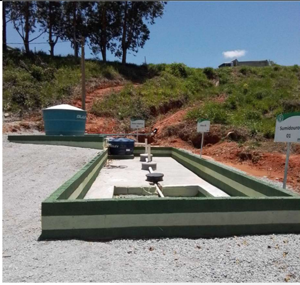
Foto 05. Sistema de Tratamento Efluentes Sanitário.
