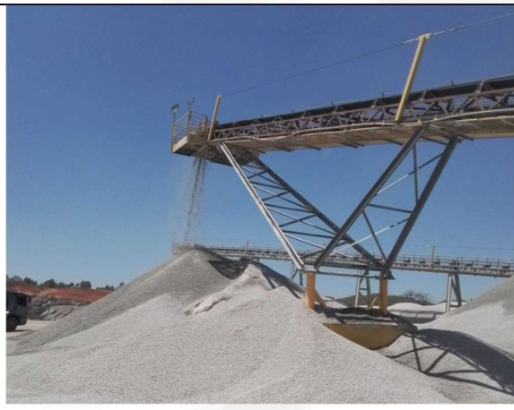
Foto 04. Aspersão de água na correia, saída do britador.
