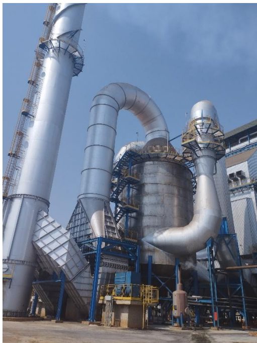
Foto 03. Lavador de gases da caldeira.
