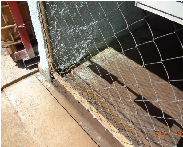
Foto 15 – Detalhe das canaletas presentes no local de abastecimento de combustível. Verificou-se a necessidade de manutenção e adequação para melhor funcionamento.
