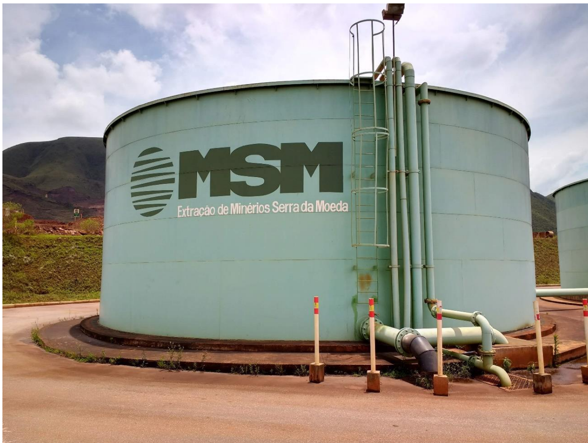
Figura 45: Vista de um dos reservatórios de água. Fonte: EIA, pág. 85, 2023.
