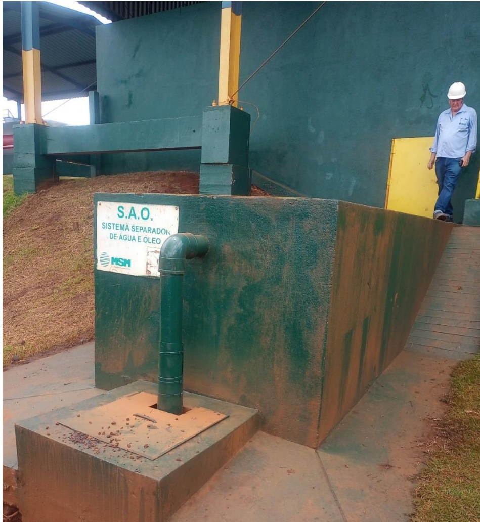
Figura 60: Vista da Caixa SAO. Fonte: Auto de Fiscalização nº 243153/2024
