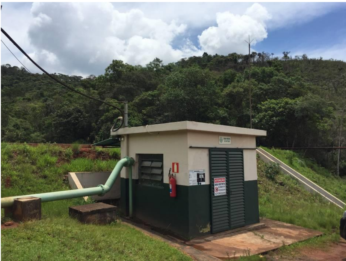
Figura 13: Sistema de bombeamento de água. Fonte: EIA, pág. 90, 2023.
