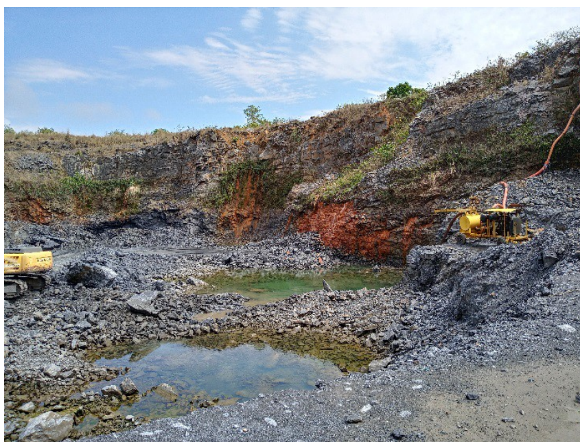
Panorama da cava e do sistema de bombeamento no corpo 03
