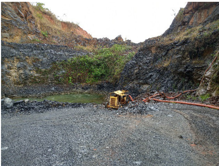
Sistema de bombeamento na cava 05
