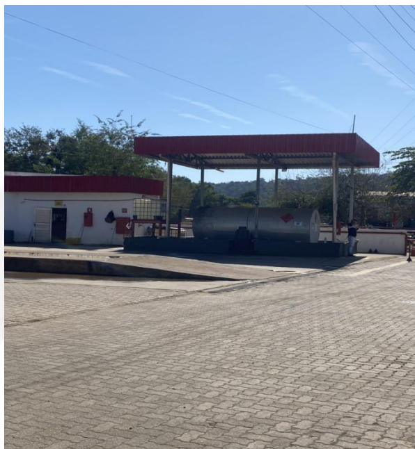
Foto 02. Ponto de abastecimento dos veículos
