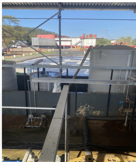
Foto 04. Estação de tratamento de efluentes (ETE)
