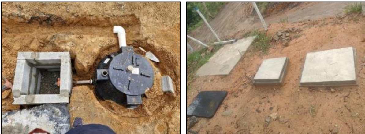
Figura 16: Sistema séptico instalado no porto da fazenda Pasto da Usina
