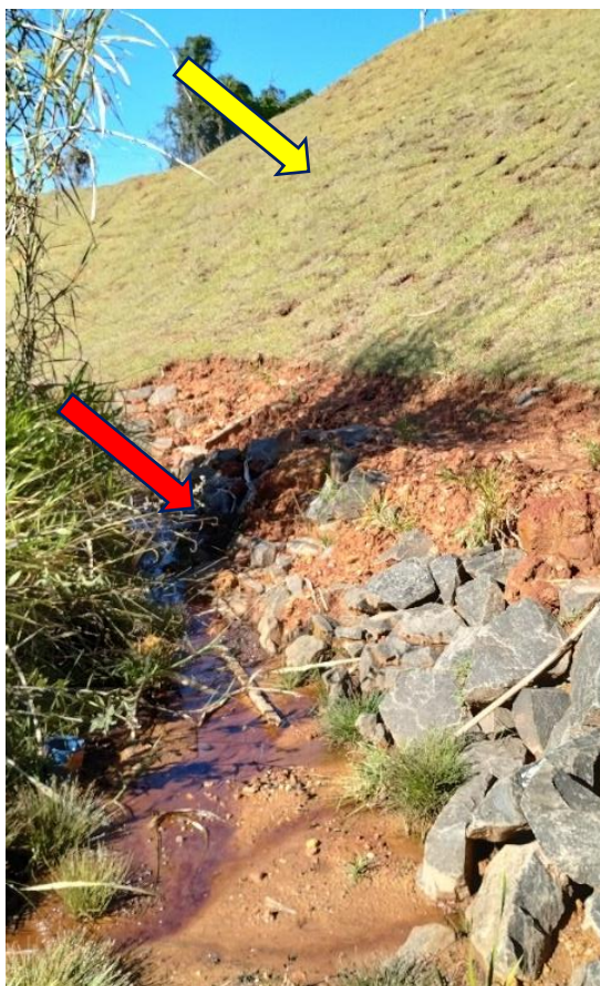
Figura 1: Danos causados no pé do talude
