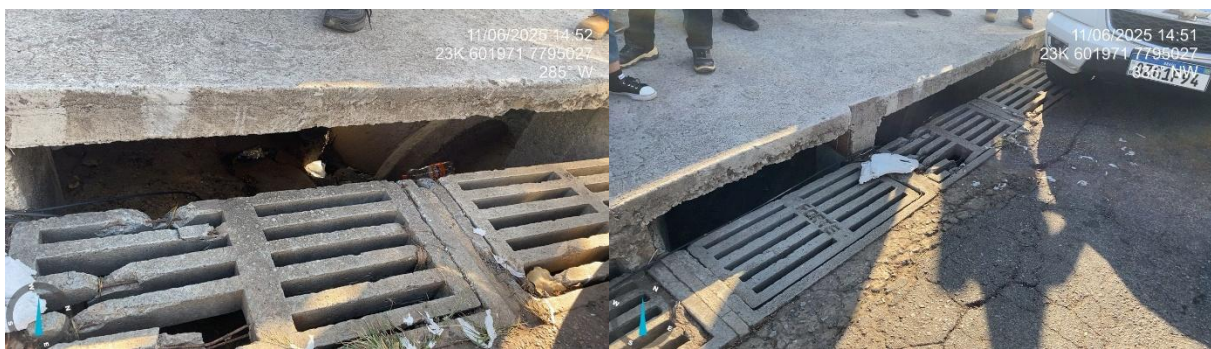
Figura 4 – Bocas de lobo instaladas nas vias públicas, com escoamento pluvial direcionado para o curso d'água canalizado
