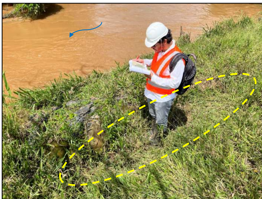
Figura 17- Destaque para abatimento de material a montante de gabião, na margem esquerda da travessia.
