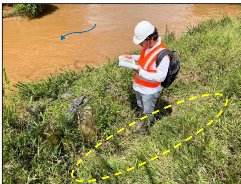
Figura 17- Destaque para abatimento de material a montante de gabião, na margem esquerda da travessia.
