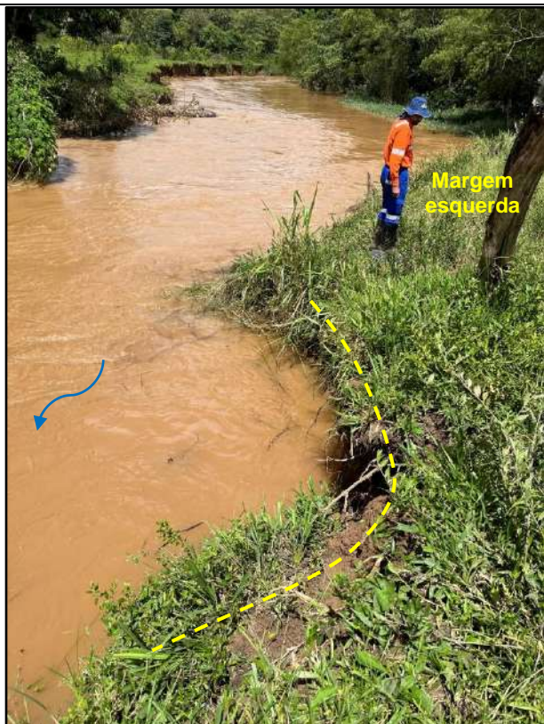
Figura 15 – Visada O-E da margem esquerda, com destaque para feições erosivas a jusante da travessia.
