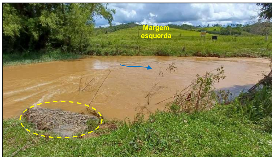
Figura 14 - Visada da travessia com destaque para gabião danificado.
