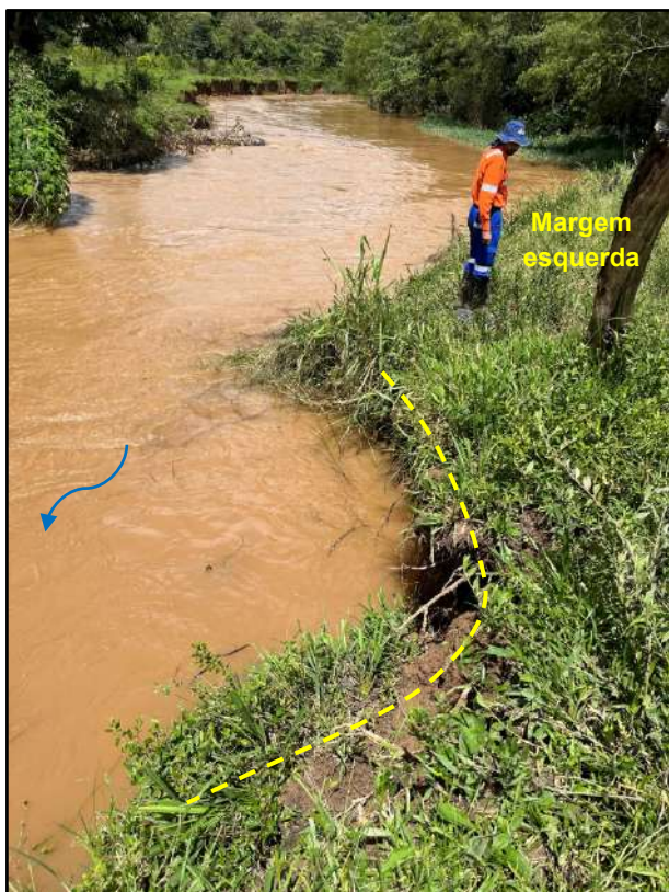
Figura 15 – Visada O-E da margem esquerda, com destaque para feições erosivas a jusante da travessia.
