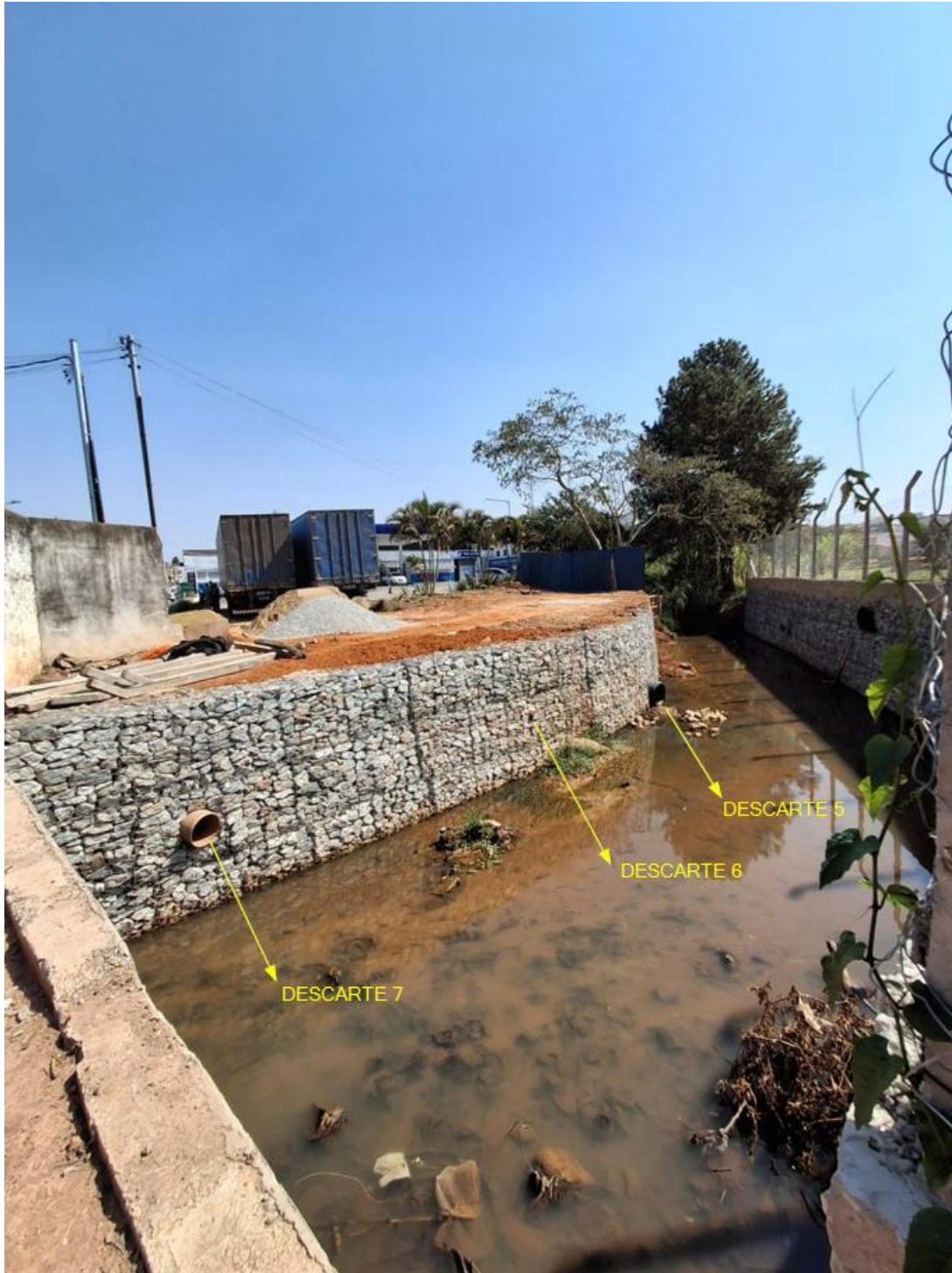
Figura 12 – Descartes pluviais observados na margem esquerda
