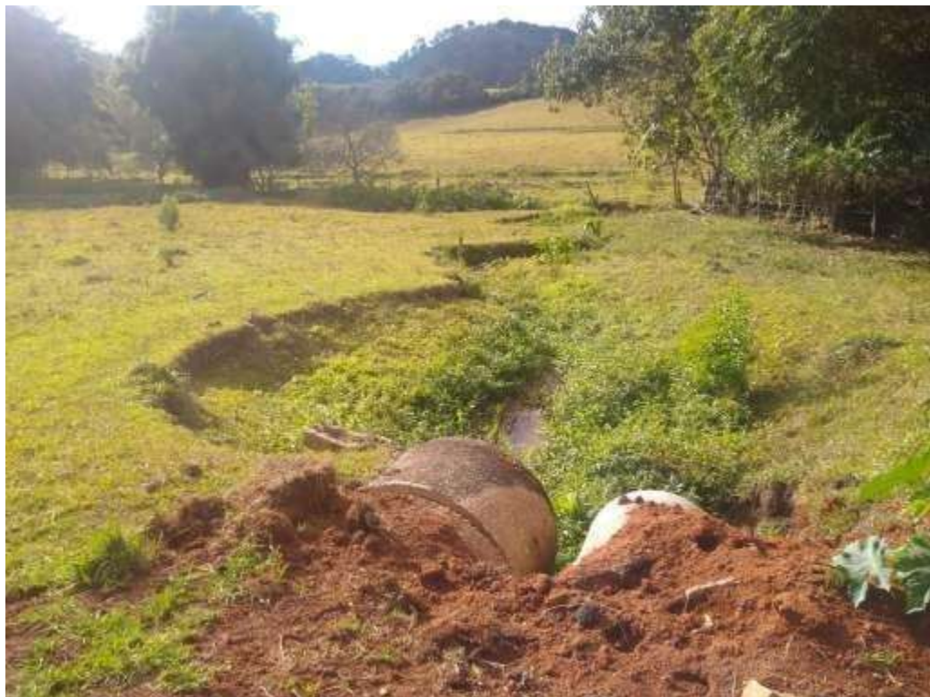
Figura 8: Imagem do fim da canalização. Coordenadas de referencia: 22°33'8.88''S e 45°55'28.71''O. A manilha mais clara é responsável pela captação da água da chuva. Foto 23/06/2021.
