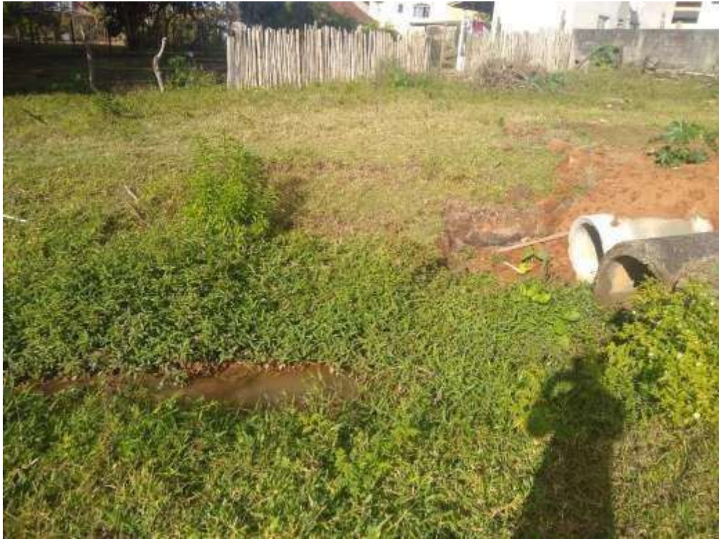
Figura 9: Imagem do fim da canalização, onde o curso de água volta a correr aberto. Foto 23/06/2021.
