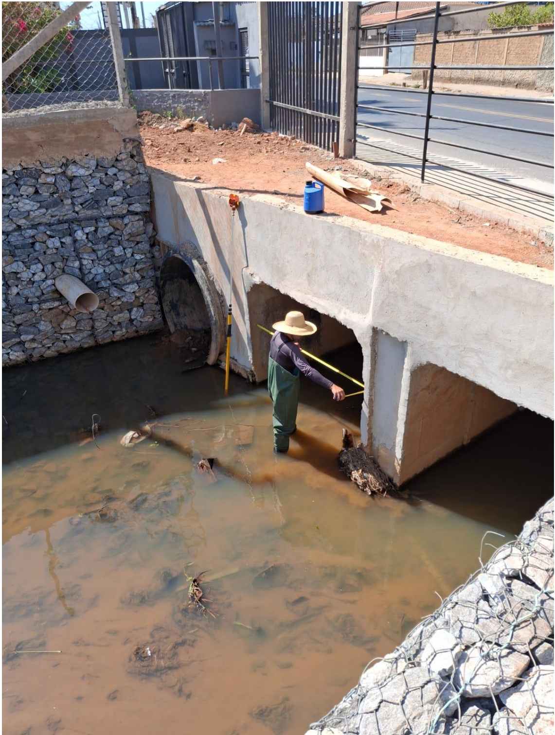
Figura 33 – Medição da largura do bueiro celular
