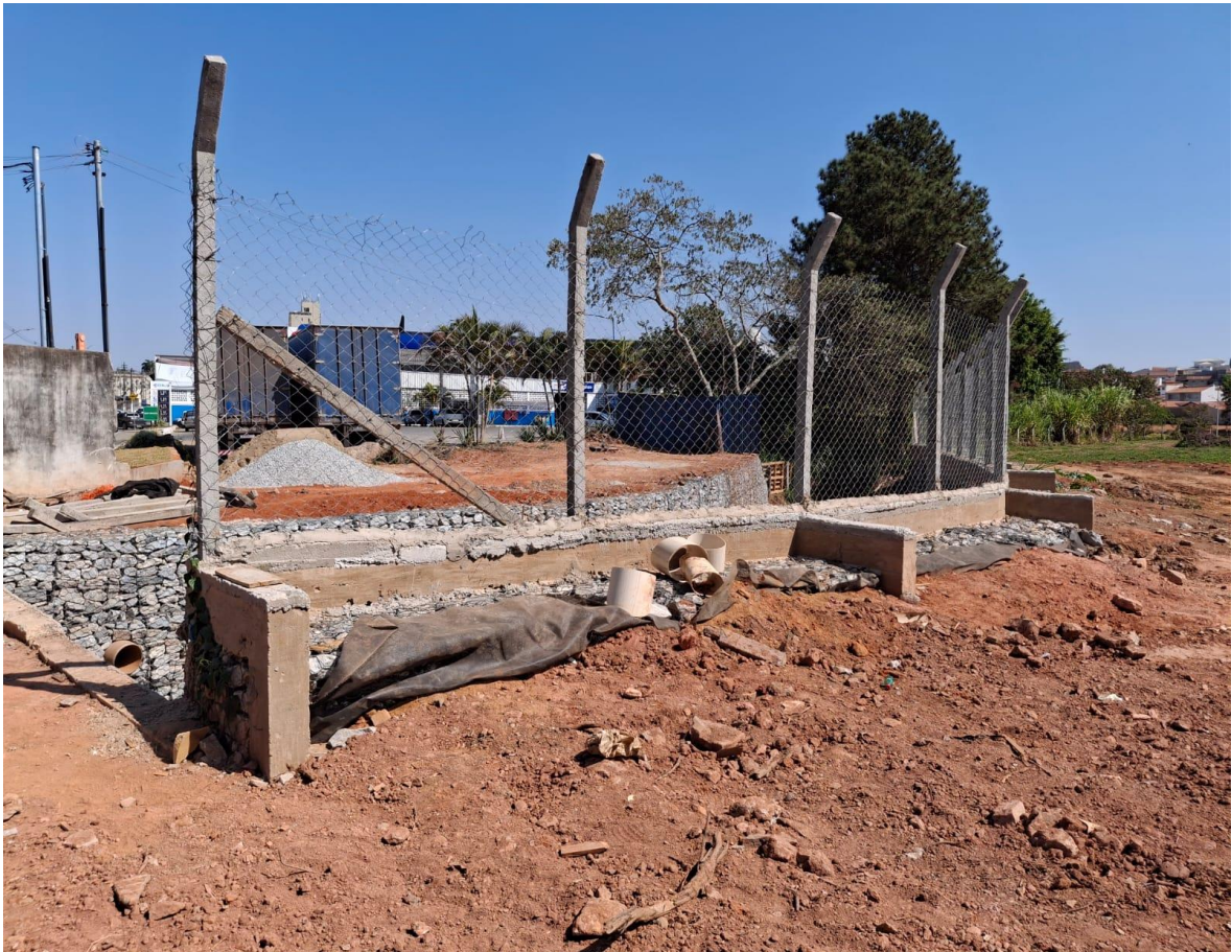
Figura 18 – Vista traseira do gabião na margem esquerda
