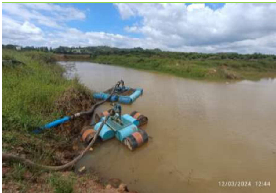
Foto 9: Sistema de bombeamento de água nova para utilização na UTM.
