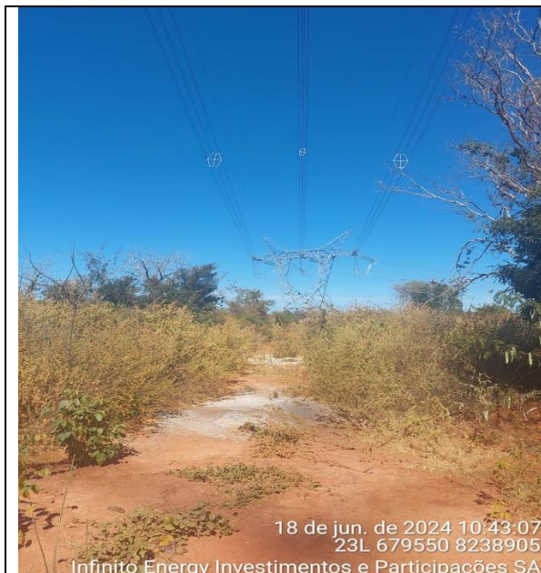
18 de jun. de 2024 10:43:07 23L 679550 8238905 Infinito Energy Investimentos e Participações SA Figura 01. Local de iconexão da Subestação Coletora da UFV Infinito Janaúba e a Subestação Janaúba 3. Fonte: Acervo URA NM.
