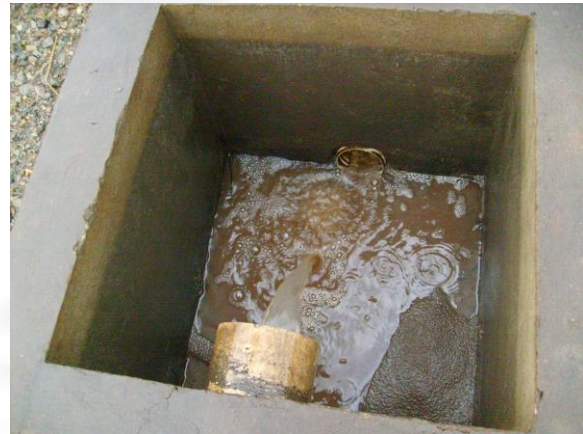
Foto 08. Caixa de recebimento de água pluvial.
