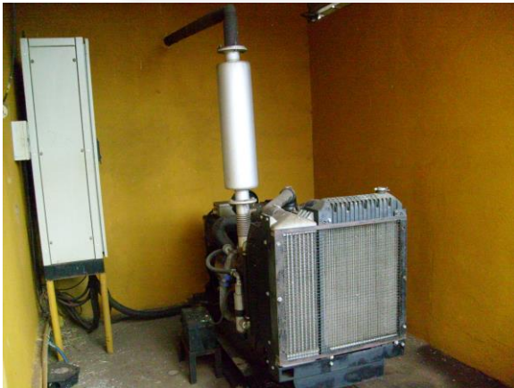
Foto 07. Gerador a diesel.
