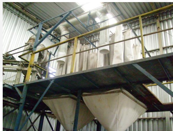
Foto 09. Estrutura Filtro de Mangas.
