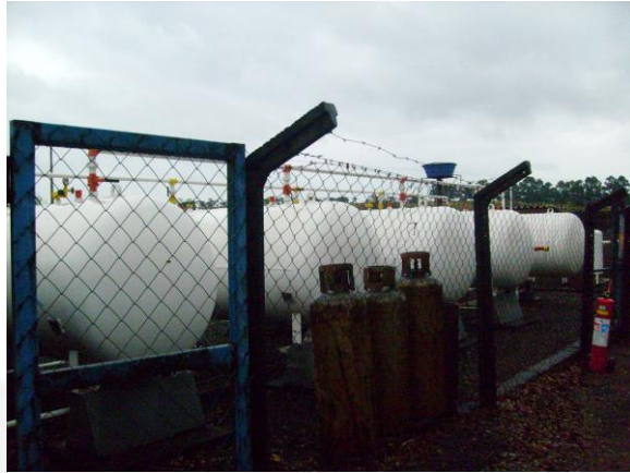
Foto 06. Base de GLP.
