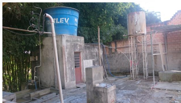
Figura 10 - Reservatório de água
