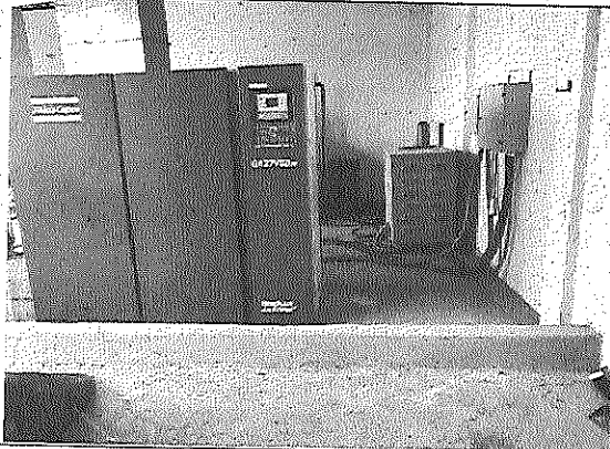
Foto 03 – Compressor com bacia de contenção
