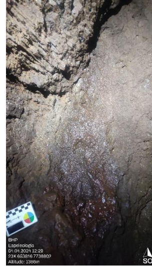
Foto 14: Ponto de percolação hídrica observada na cavidade durante vistoria.
