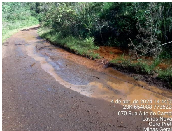
Foto 13: Pequeno trecho da estrada em que o curso d'água corre pelo leito da estrada.
