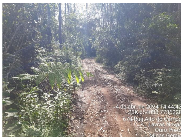
Foto 16: Porção do acesso muito estreito com vegetação crescendo para dentro do leito de estrada.
