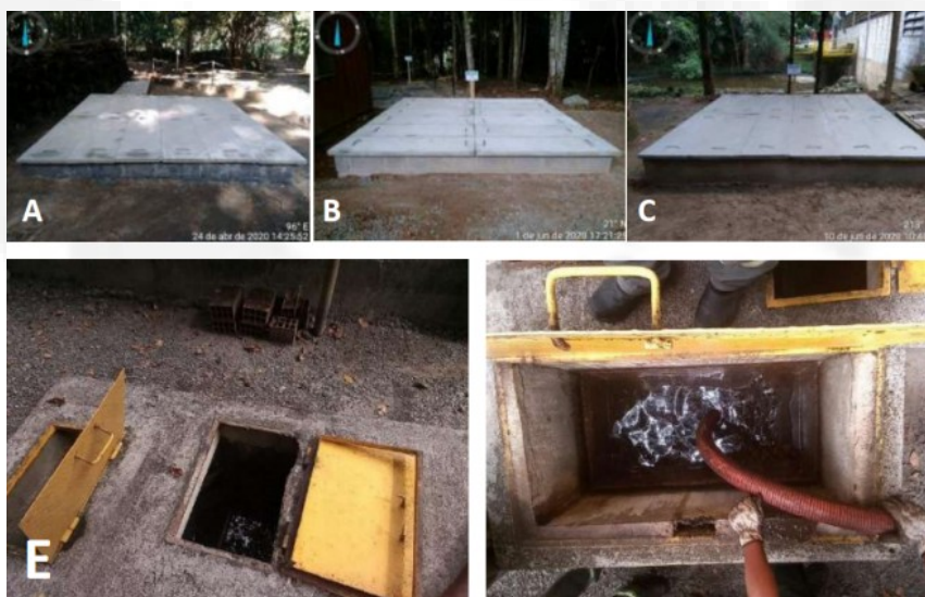
Figura 12 - Caixas estanque instaladas a partir de junho de 2020 para recolhimento dos efluentes sanitários, junto à guarita (A), vestiário (B) e casa de força (C). (E) Caixas Separadores Água/Óleo (CSAO). Fonte: Vale, 2020 e Rio Novo Energias Renováveis Ltda, 2023.
