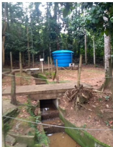
Figura 3 - Captação em curso d'água para instalações hidrossanitárias da PCH Mello. Fonte: Feam, 2025.
