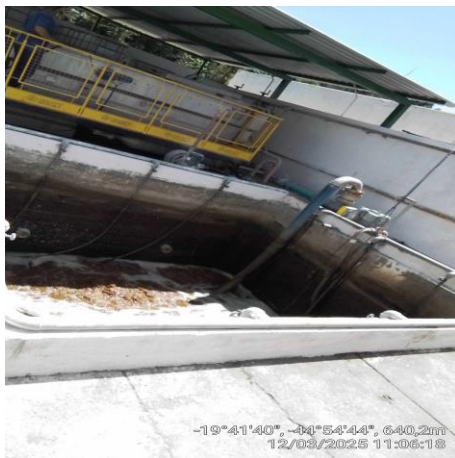
Foto 01. Estação de Tratamento de Efluentes Industriais.
