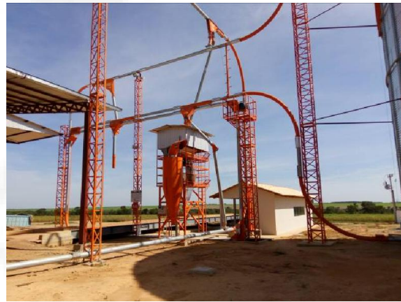
Foto 02. Sistemas de granduto.
