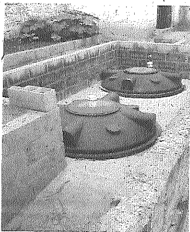
Foto 17: Estação de Tratamento de Esgoto - ETE.
