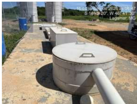
Figura 07: Caixa de Retenção Primária e de Gradeamento. Fonte: Proposta de Monitoramento - ETE São Brás (2026).
