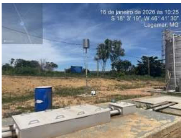
Figura 09: Distribuidor de Vazão.
