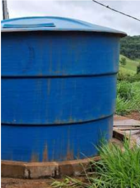
Figura 03: Tanque de decantação
