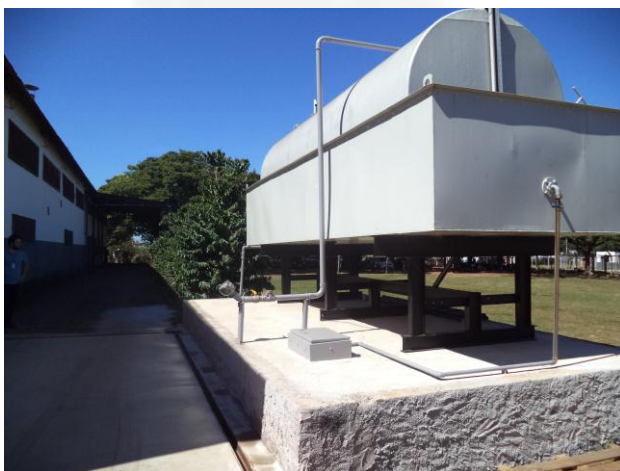
Sistema de armazenamento de diesel.
