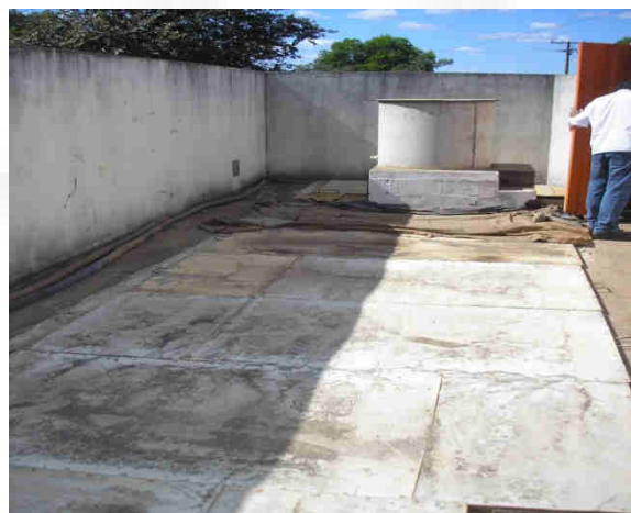
Foto 4: Sistema separador de água e óleo.
