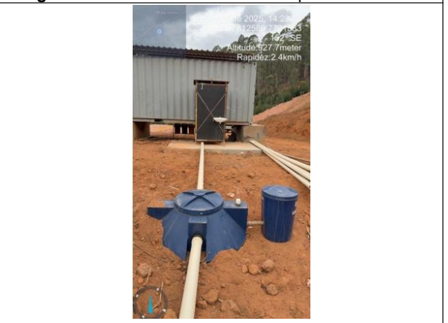
Imagem 04: Vista parcial das estruturas instaladas e biodigestor.
