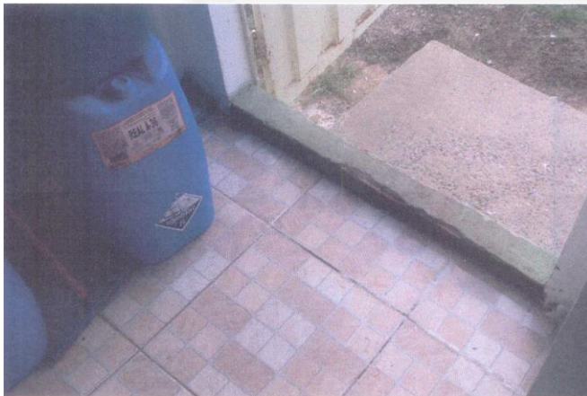
Foto 01. Depósito de produto químicos com bacia de contenção
