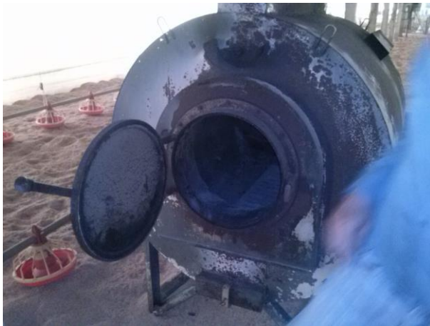
Foto 05. Fornalha de aquecimento
