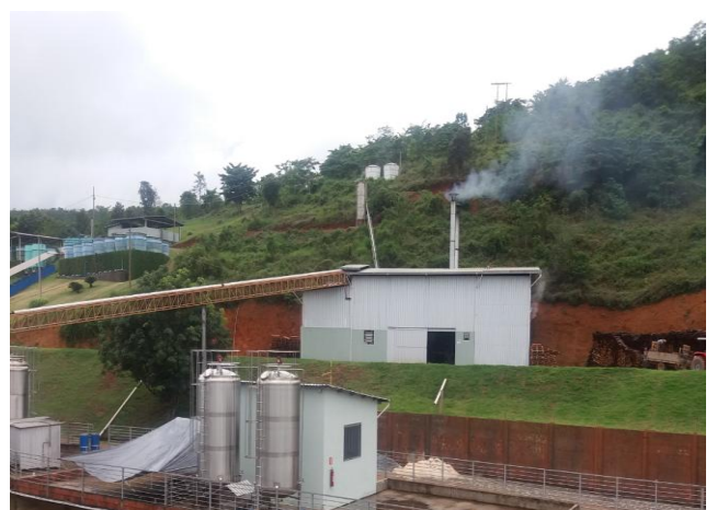
Foto 06: Caldeira à lenha.
