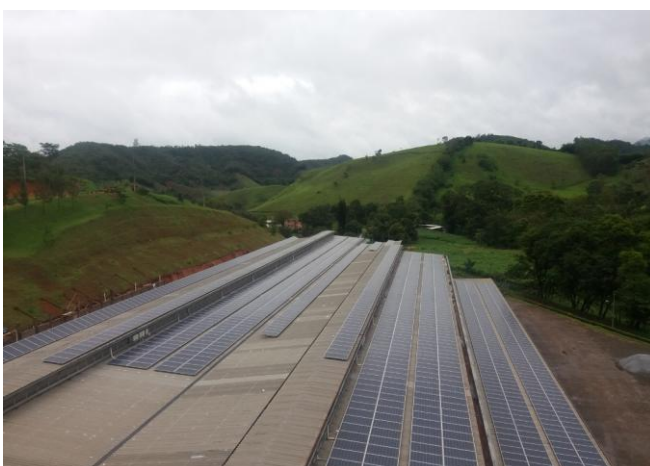
Foto 05: Sistema de energia solar fotovoltaica.
