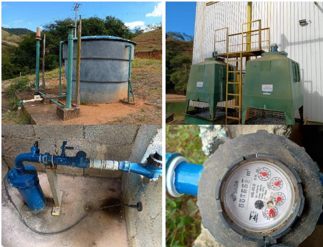
Figura 7 - Sistemas de captação e armazenamento de água na PCH Corrente Grande.
