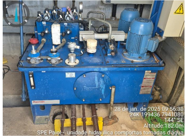
Foto 08: Unidade hidráulica de acionamento das comportas extravasoras.
