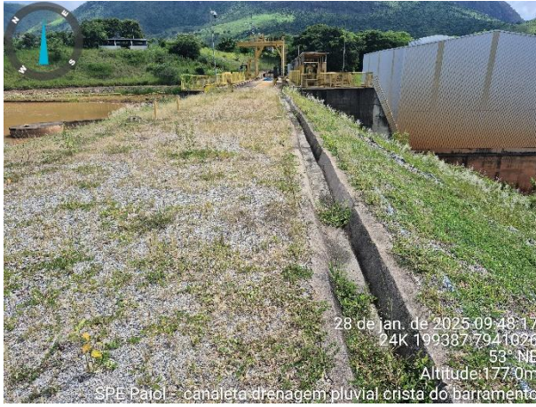
Foto 37: Sistemas de drenagem (canaletas) do barramento.
