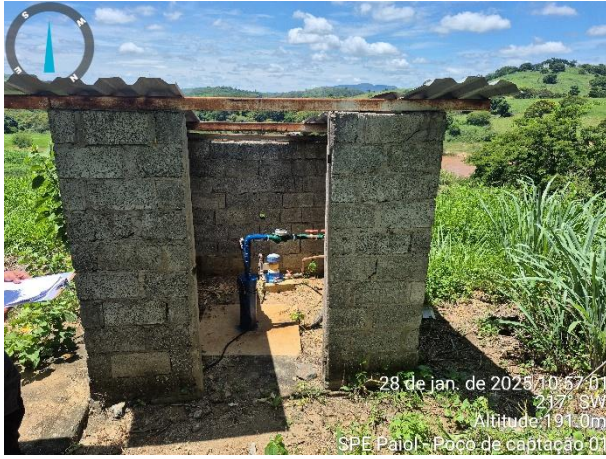
Foto 31: Local de instalação do poço 01. Detalhe para estrutura avariada.
