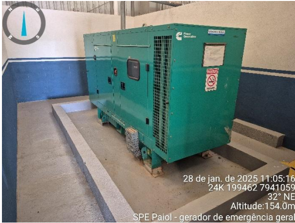
Foto 53: Gerador de emergência.
