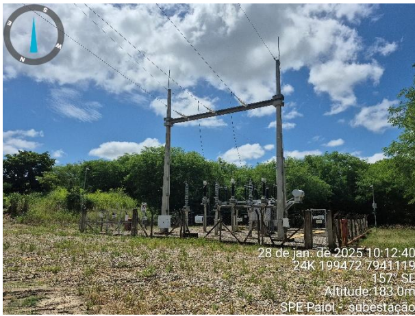
Foto 15: Subestação de energia do empreendimento.
