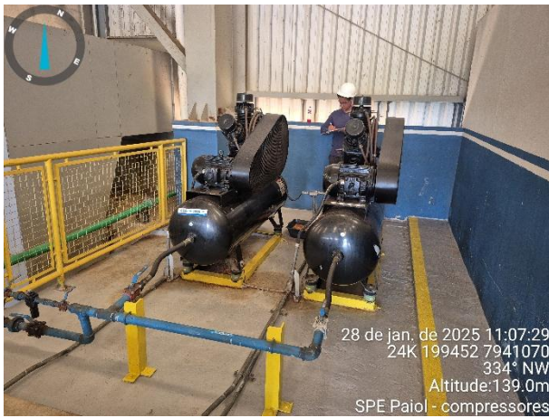
Foto 09: Compressores da Casa de Força.
