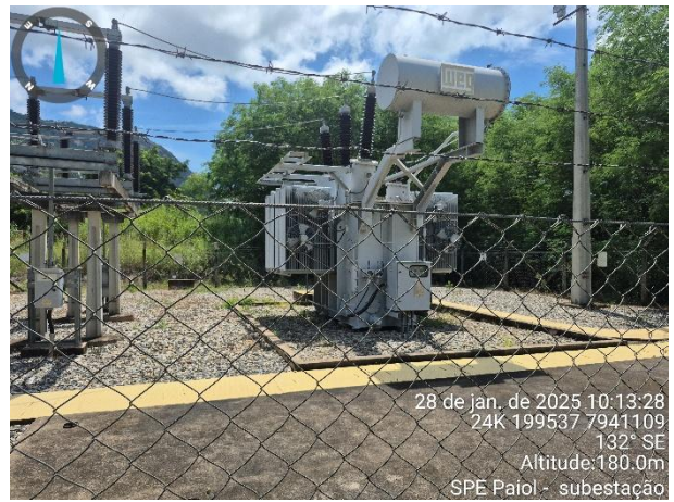
Foto 16: Transformadores instalados em piso rebaixado e com base concretada na subestação.
