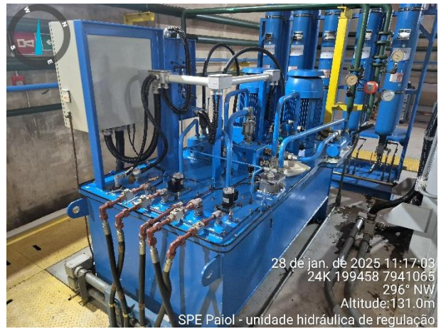
Foto 10: Unidade hidráulica de regulação.
