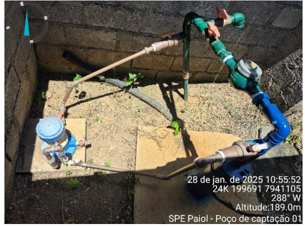
Foto 32: Equipamentos instalados do poço 01.
