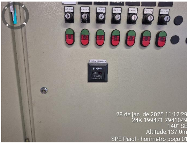
Foto 33: Horímetro dos poços 01 e 02.
