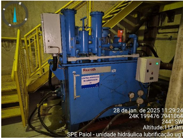
Foto 11: Unidade hidráulica de lubrificação da unidade geradora.
