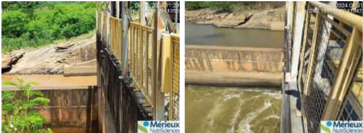
Figura 24 - Saída da CSAO da PCH Paiol.
