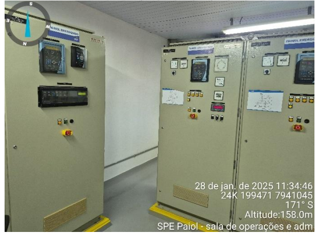
Foto 14: Quadros elétricos de controle e operação da usina.
