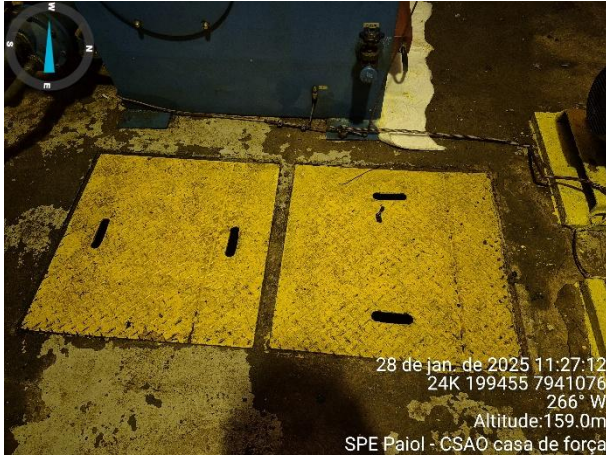
Foto 13: Caixa Separadora de Água e Óleo (CSAO) existente na Casa de Força.
