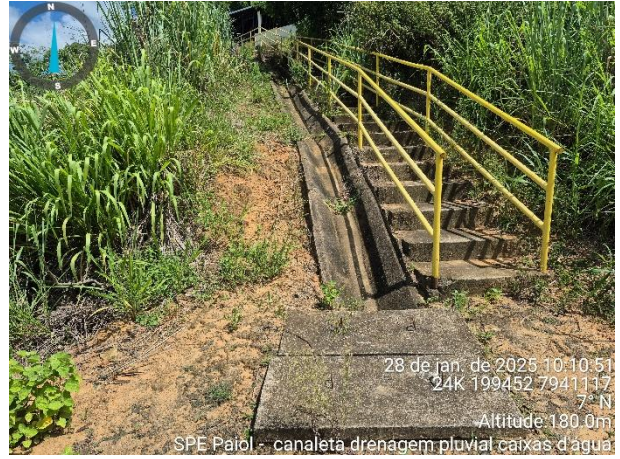
Foto 38: Caixas de passagem pluvial do empreendimento.
