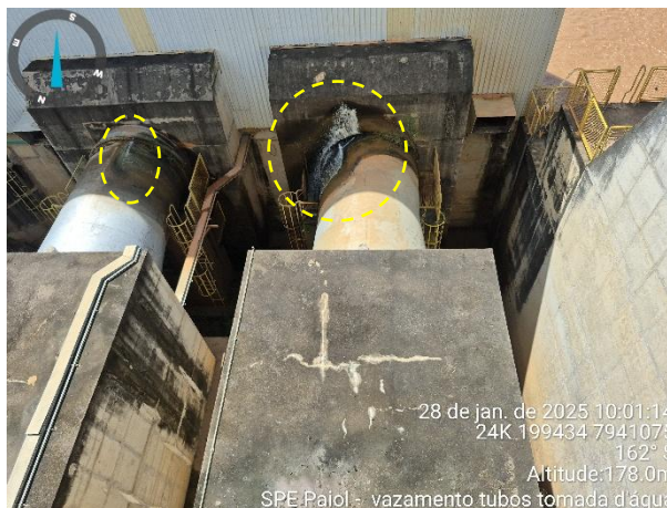
Foto 06: Condutos forçados que levam a água para as unidades geradoras. Detalhe para os vazamentos existentes nos condutos (círculos tracejados em amarelo).
