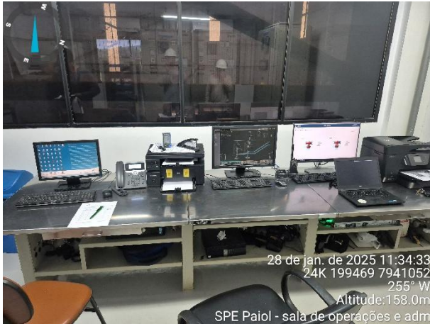
Foto 23: Sala de controle e operações.
