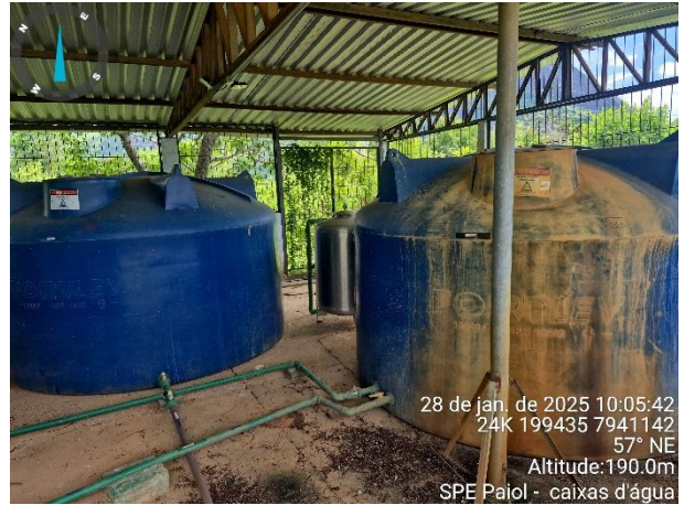
Foto 36: Reservatório para armazenamento de água dos poços.
