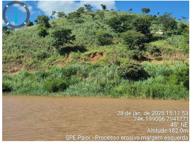
Foto 52: Processo erosivo margem esquerda do reservatório.
