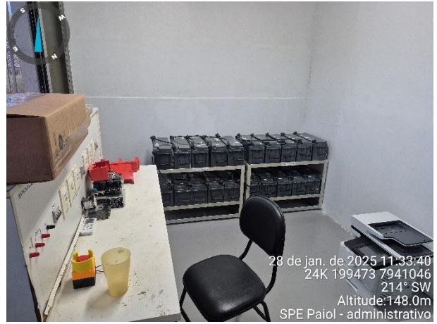
Foto 22: Sala de baterias.
