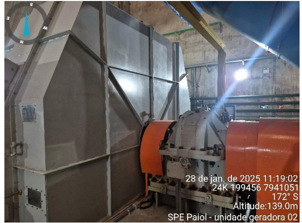
Foto 12: Unidade geradora de energia elétrica da Casa de Força.
