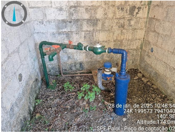
Foto 35: Ausência de laje sanitária do poço 02.
