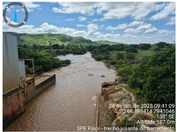
Foto 18: Trecho a jusante do barramento e canal de fuga. Detalhe para inexistência de TVR.
