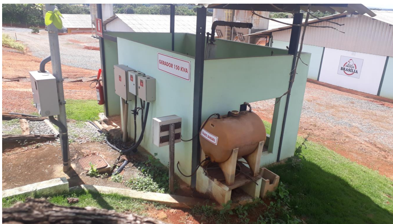
Figura 5 - Visão do sistema de geração de energia de emergência – a ser adequado.
