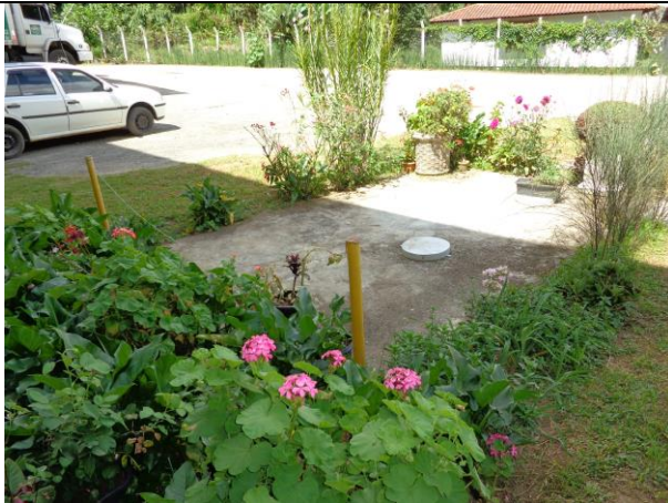
Foto 13: Sistema de tratamento de esgoto sanitário (fossa séptica-filtro anaeróbio)
