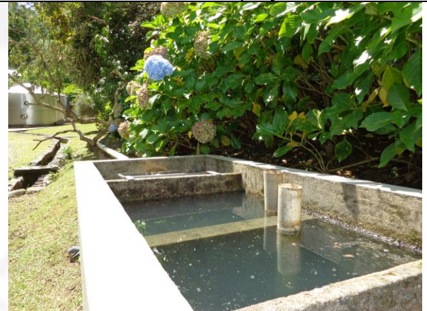
Foto 08: Sistema de Tratamento de Efluente Industrial
