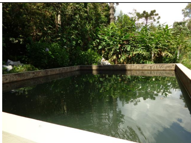
Foto 09: Sistema de Tratamento de Efluente Industrial
