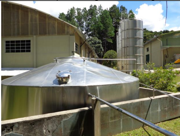
Foto 07: Tanques de armazenamento
