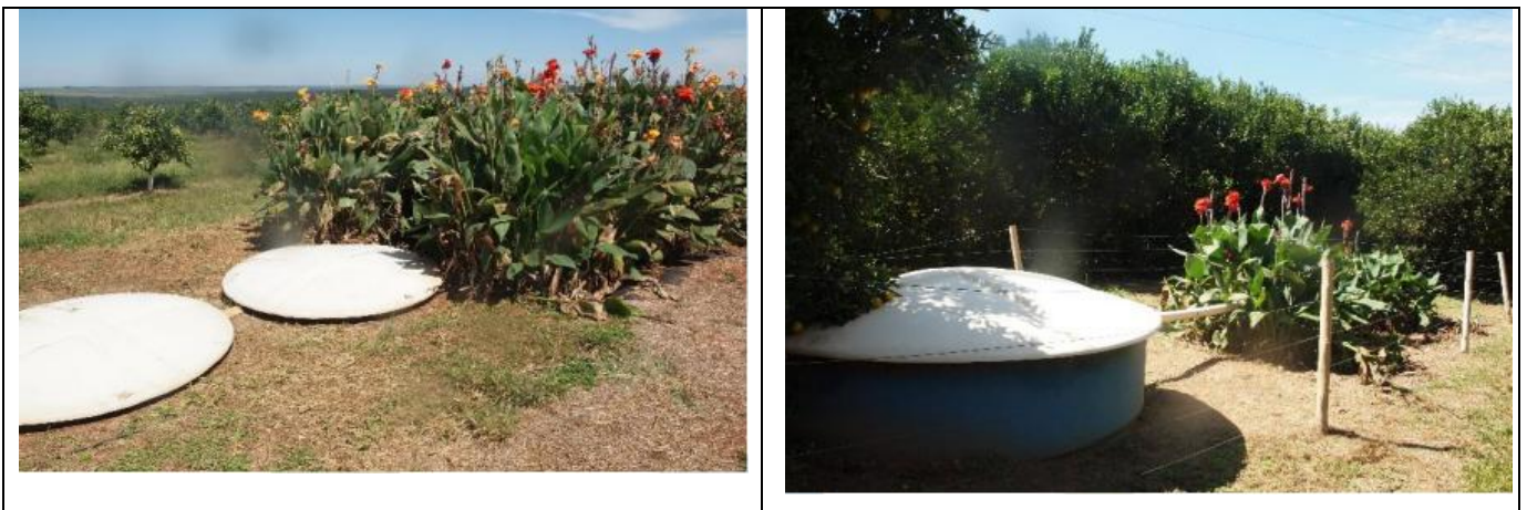
Figura 06 - Fossas sépticas do empreendimento. Fonte: Estudos ambientais, 2022.
