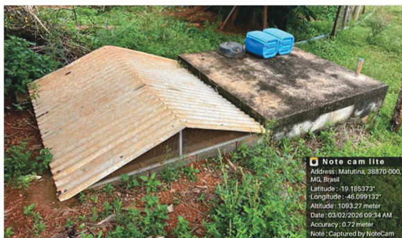
Foto 03. Vista - sistema de tratamento de efluentes sanitários
