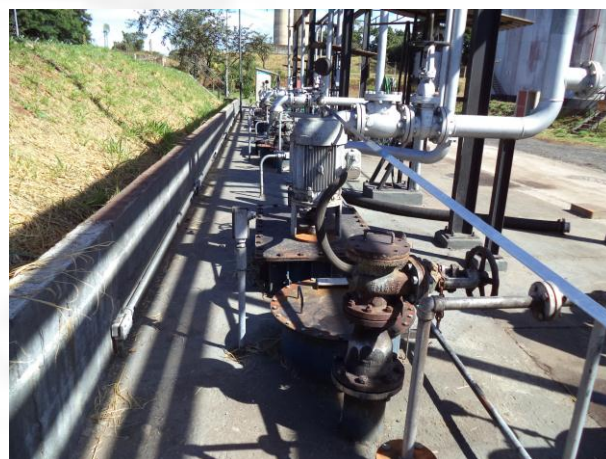
Foto 02. Área dos tanques pulmão
