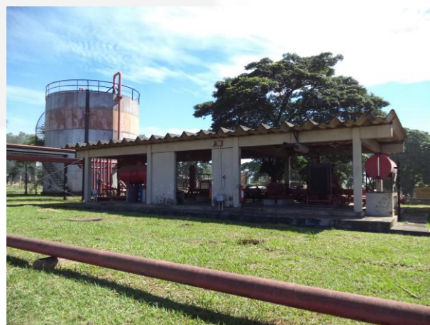
Foto 10. Sistema de combate a incêndio
