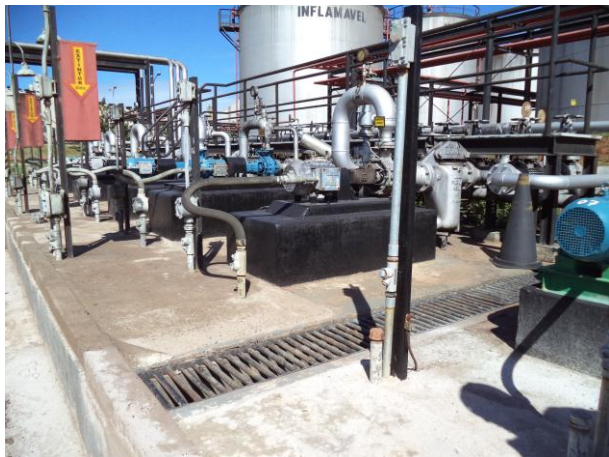
Foto 05. Parque de bombas
