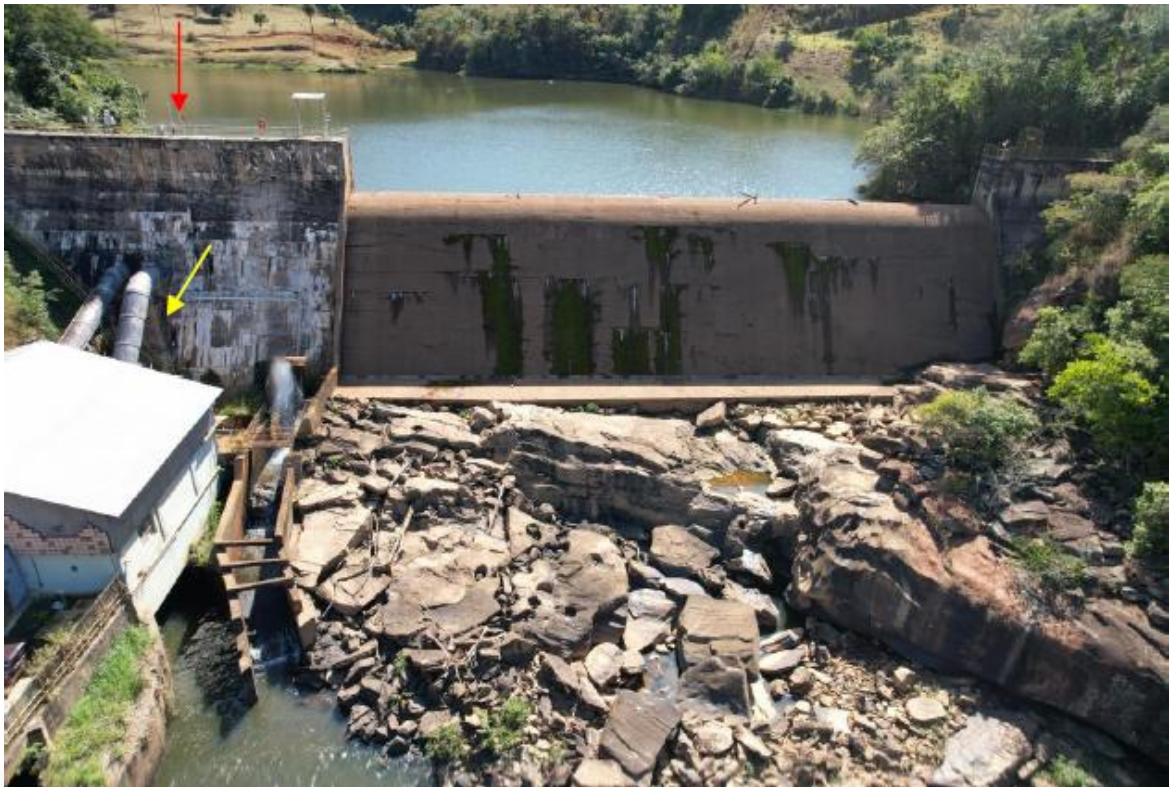
Figura 5: Vista aérea da tomada d'água (seta vermelha) e dos condutos forçados (seta amarela). Fonte: RADA, 2024 (pág. 14).
