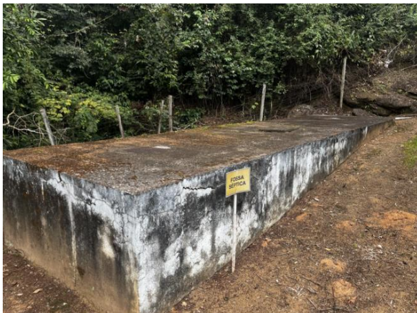
Figura 29 - Sistema de tratamento de efluentes.
