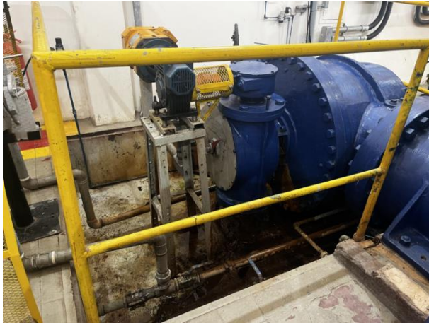
Figura 27 - Bacia de contenção.
