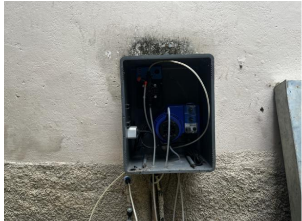
Figura 31 - Estação de cloração.
