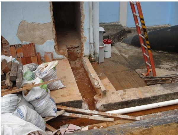
Figura 55 - Interligação fossa séptica aos sanitários.
