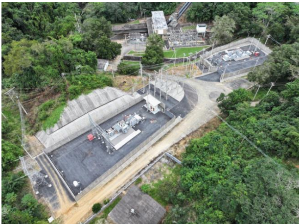
Figura 16 - Vista geral das subestações (Cemig D).
