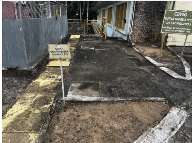
Figura 28 - Caixa SAO para atendimento à Subestação.
