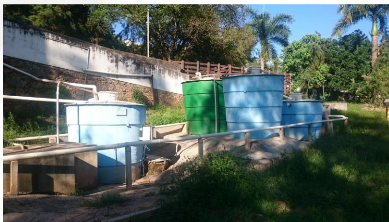
FOTO 03. Estação de Tratamento de Efluentes – ETE
