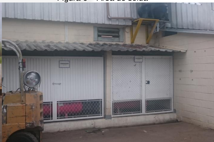
Figura 8 – Área dos compressores
