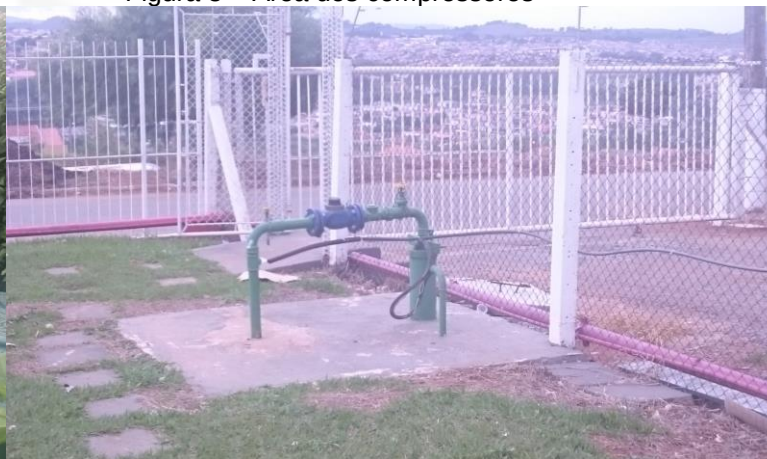
Figura 10 – Poço tubular existente
