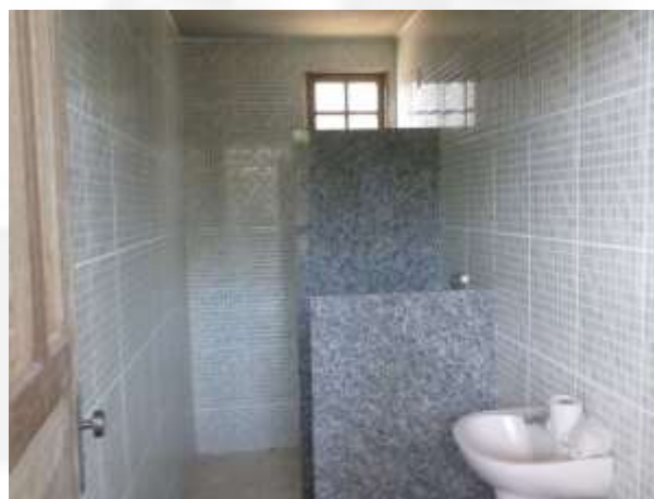
Foto 04. Sanitário instalado no Galpão
