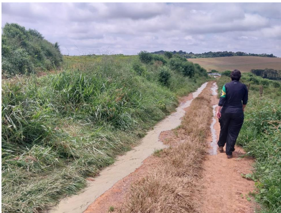
Figuras 4 e 5: Vazamento de efluente bruto. Fonte: fiscalização “in loco”.
